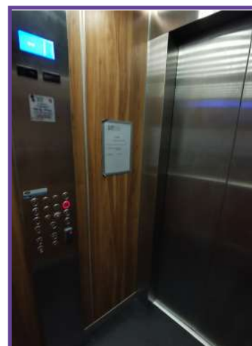
Commandes intérieures ascenseurs
